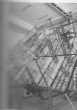
Рисунок 1 - Монтаж со смещением
